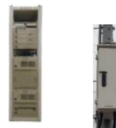
280MHz防災システム関連機器
